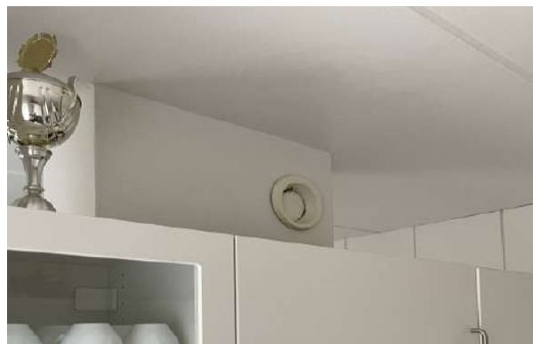
Eksisterende aftræk i køkken
